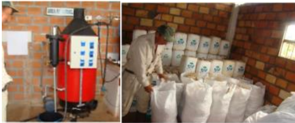
Fotografía 11. Autoclave y almacenamiento de residuos
