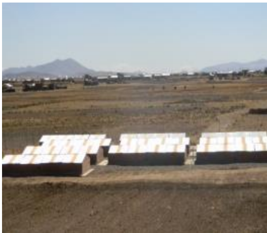
Fotografía 3. Celdas de tratamiento de Heces
