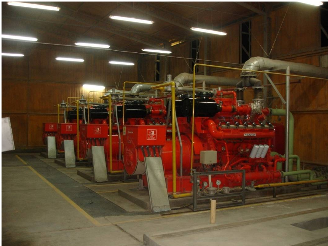
Ilustración 2: Generadores, Planta “El Puente”
