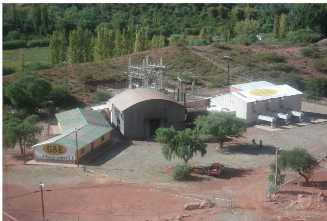
Ilustración 1: Planta de Generación “Camargo”
